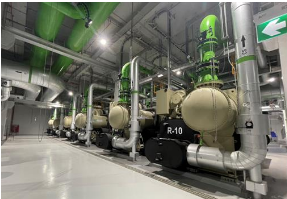
プラントに設置した世界最高水準の高効率冷凍機
